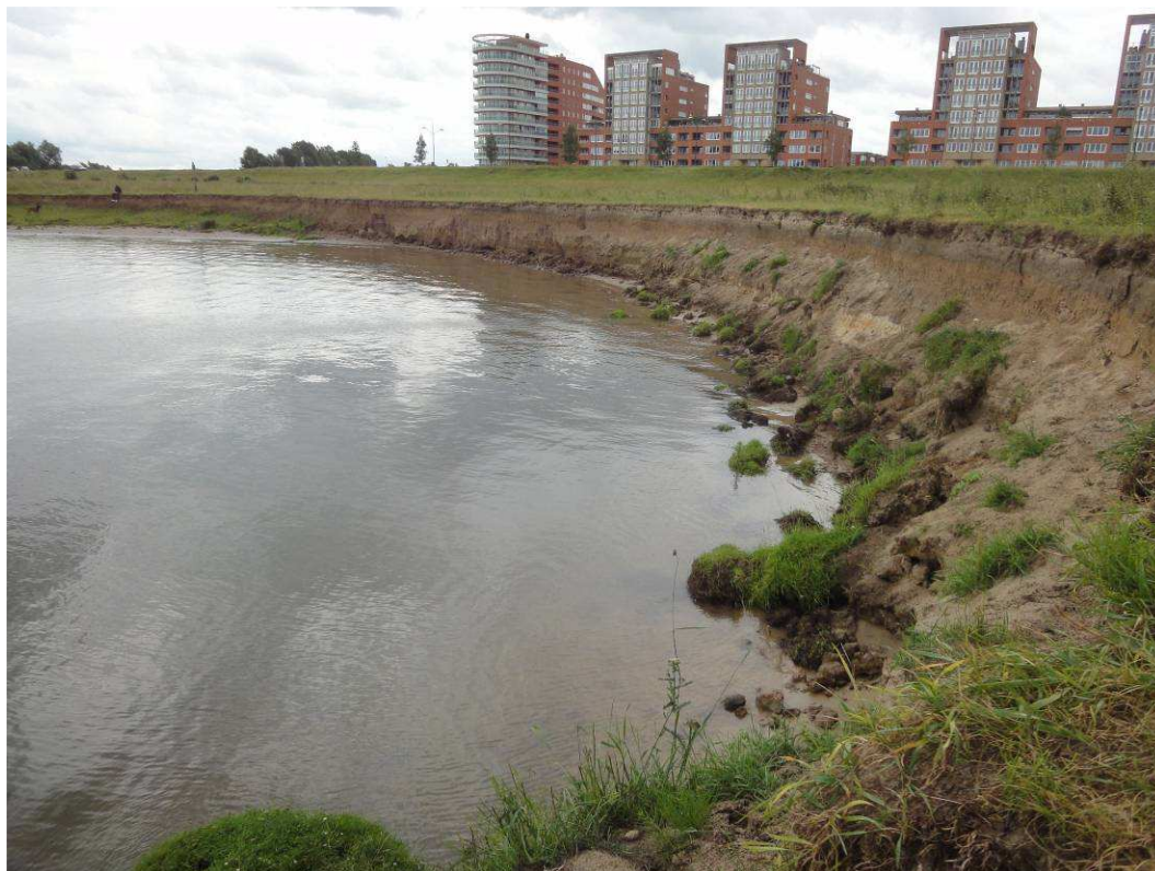
De grote erosieboog van Oude Schans, met zandig oevermateriaal (foto Bart Peters).
