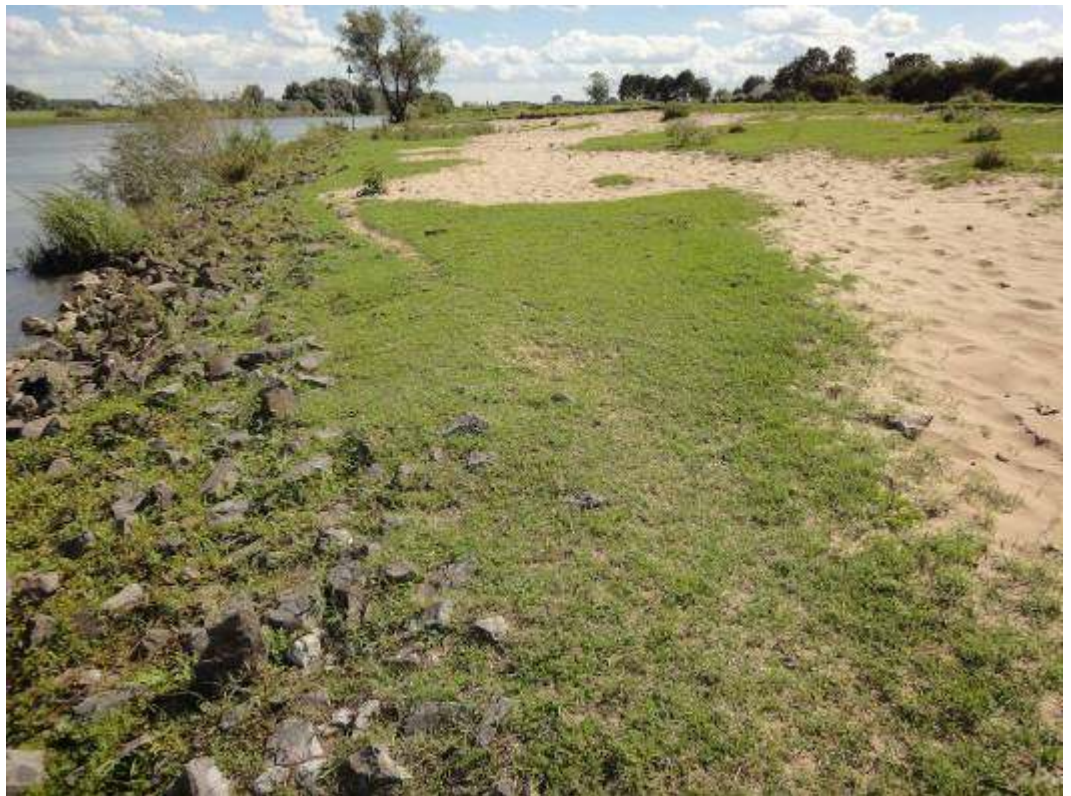
Figuur 18 Erosiekuilen in de oeverwal net achter de zware breuksteenbestorting in de IJsseloever bij Cortenoever (foto Bart Peters).
